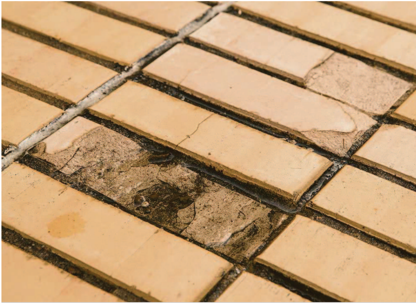
Überall auf dem Peter-Kaiser-Platz gibt es abgesprengte oder gerissene Klinkersteine.
